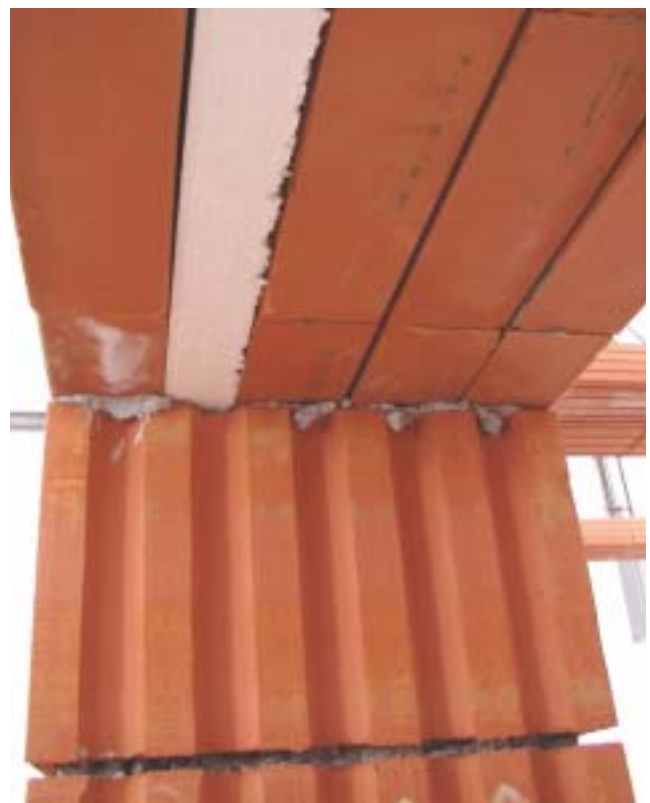
Pohľad zospodu na skladbu prekladu so zabudovanou tepelnou izoláciou (hrúbka steny 38 cm)
